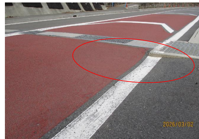
② 北林飯島線の新設横断側溝周辺の段差 (対応予定)
