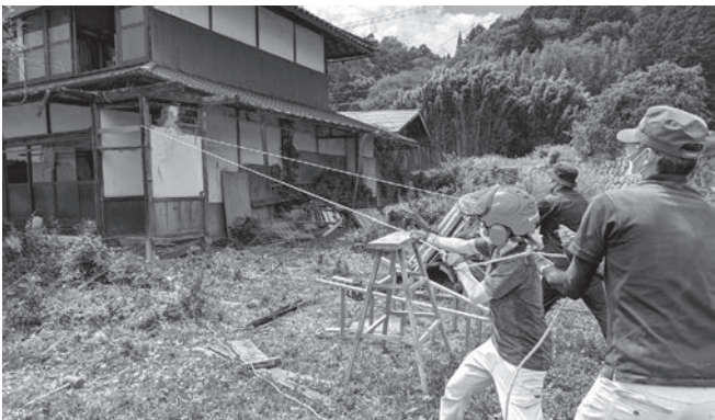
部分解体した後にロープを引っ掛け、残った増築トイレ棟を引き倒しているところです。人力でもここまでできる！と実感しました。
