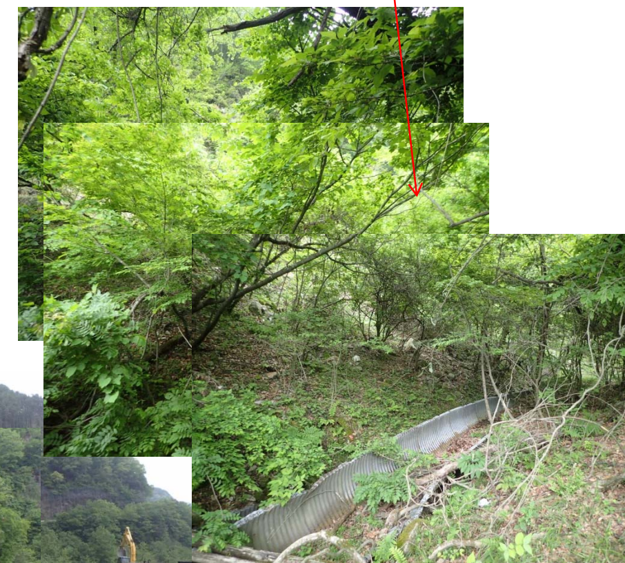
写真-049 斜面下方には崖錐堆積物が分布。沢部は、コルゲート管による水路工が設置されているが、側部が浸食され、浮き上がっている。
