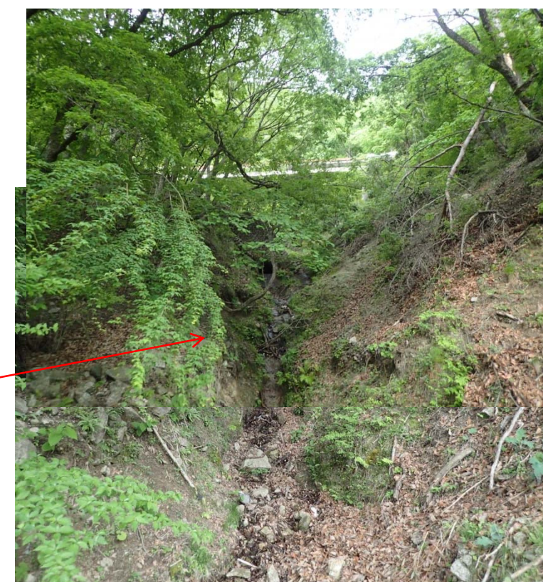
写真-052 県道 59 号の橋梁と沢の状況。表流水が認められる。
