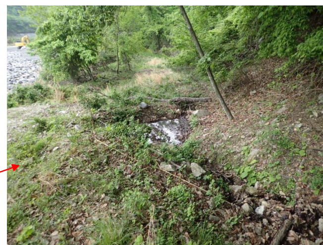
写真-051 沢の出口の状況。水溜まりとなる。
