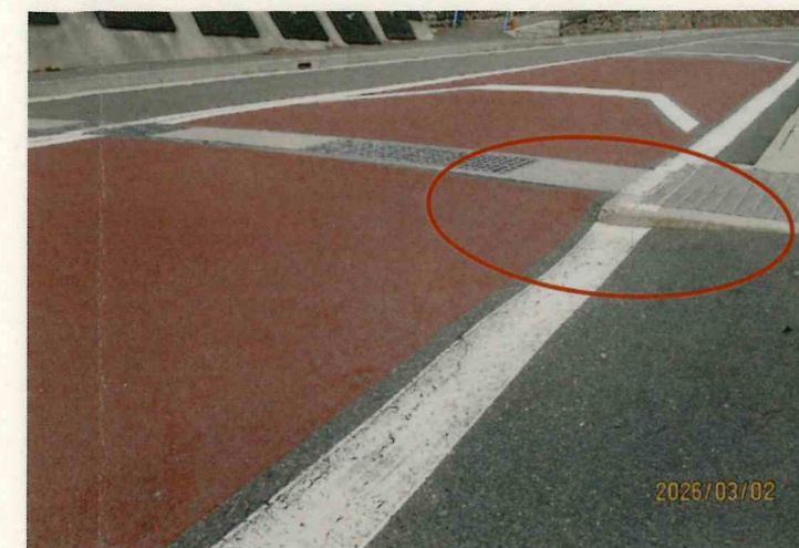
② (一)北林飯島線の新設横断側溝周辺の段差
