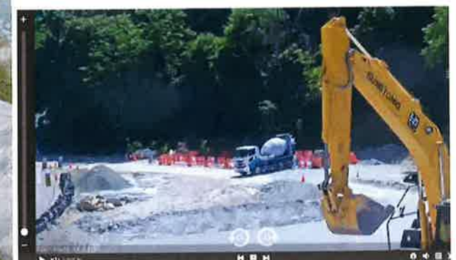
図-8 監視カメラ（録画機能付き）設置
