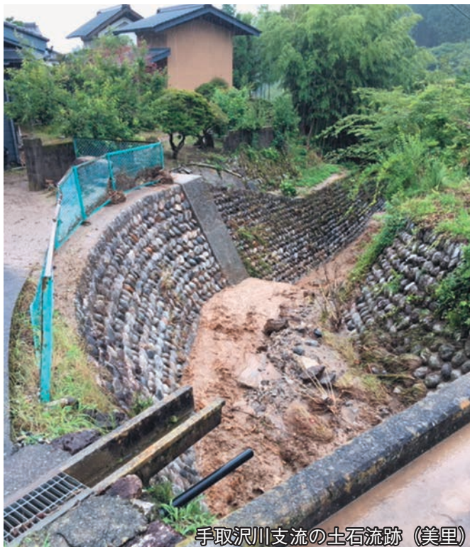
林道陣馬形線の路肩崩落（美里）
